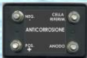
Centralina di controllo
